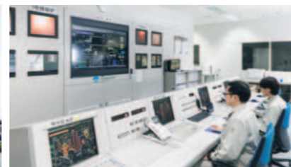
中央制御室 (シンシア品川R・Cセンター)
