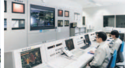
中央制御室 (シンシア品川R・Cセンター)
